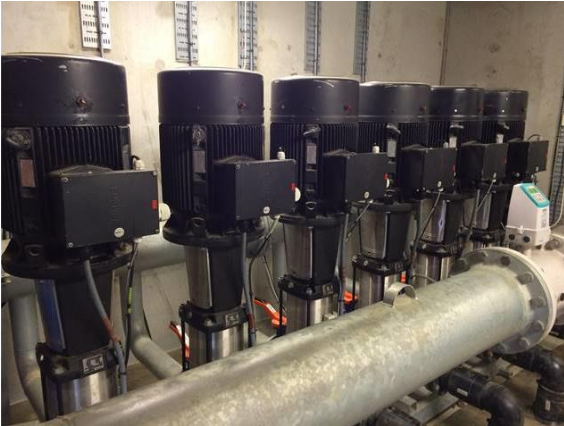
Figur 4.4: Pumperne i pumpehuse, der er tilknyttet vandingsanlægget
